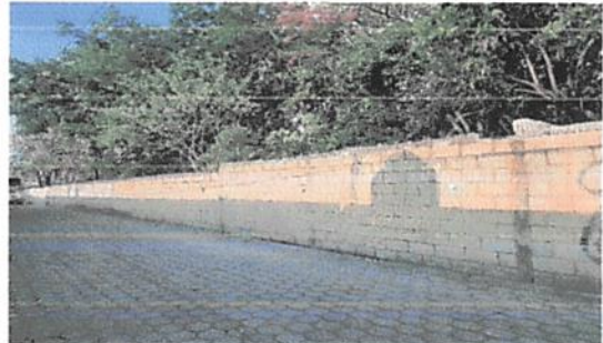
FOTO 4: ENSABIETADO EN TAPIAL DE MURO PERIMETRAL
